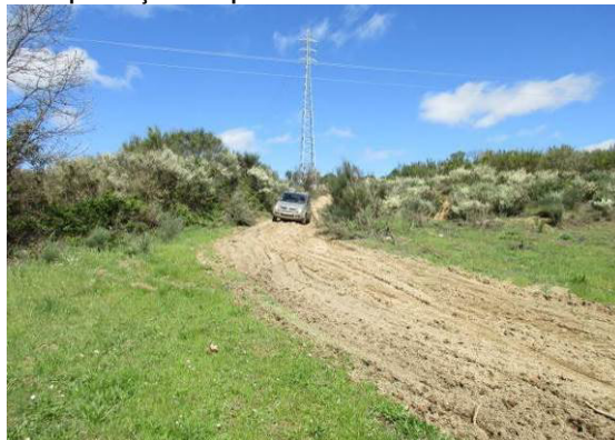
Fotografia 70 - Solo descompactado no acesso ao local de implantação do apoio 37.
