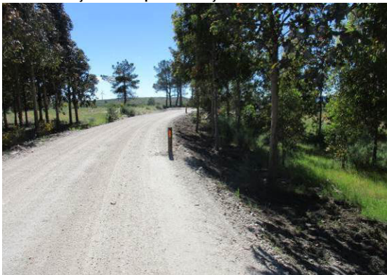
Fotografia 47 - Acesso do parque eólico (via A) sem qualquer material impermeabilizante.
