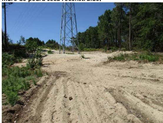
Fotografia 112 - Acesso ao apoio 59 descompactado.
