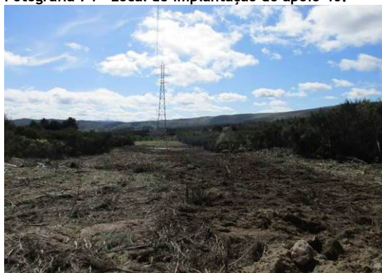
Fotografia 76 - Acesso ao apoio 41 descompactado.
