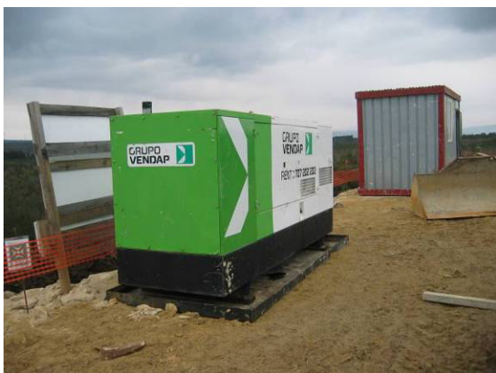
Fotografia 36 - Gerador instalado sobre uma bacia.
