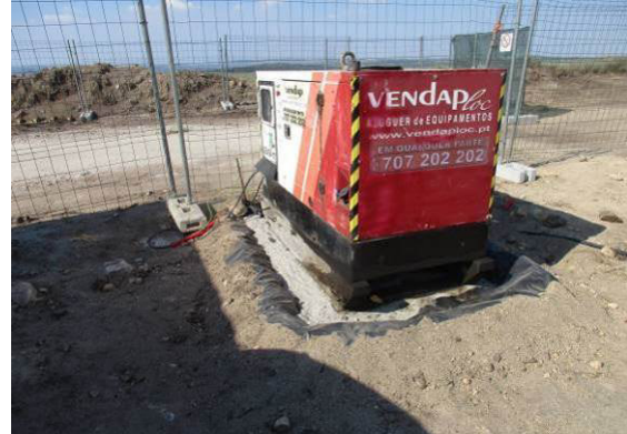
Fotografia 55 - Gerador instalado na área de estaleiro colocado sobre uma superfície impermeável e material absorvente para evitar a contaminação do solo.
