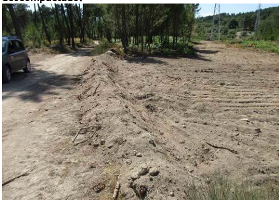
Fotografia 99 - Acesso ao apoio 54 descompactado.
