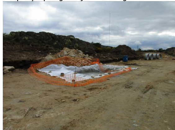
Fotografia 158 - Bacia de lavagem das caleiras das autobetoneiras na plataforma do aerogerador AG16.
