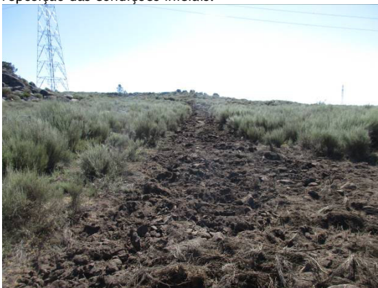
Fotografia 35 - Acesso ao apoio 18 descompactado.
