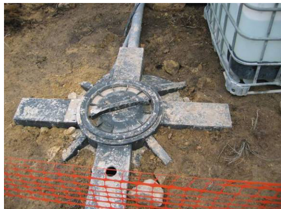
Fotografia 35 - Fossa estanque instalada para recolha dos efluentes domésticos gerados nas instalações sanitárias instaladas na área de estaleiro.
