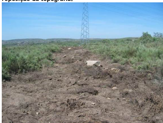
Fotografia 138 - Acesso ao apoio 72 descompactado.
