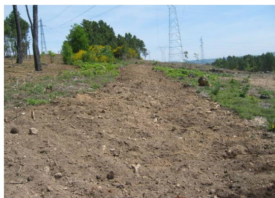
Fotografia 23 - Acesso ao apoio 11 descompactado.
