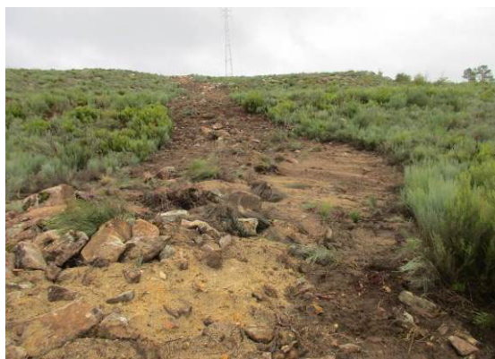
Fotografia 26 - Acesso ao apoio 11 descompactado.
