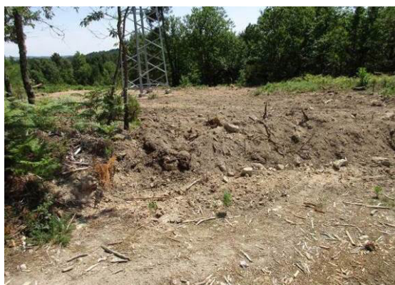
Fotografia 108 - Acesso ao apoio 57 descompactado.
