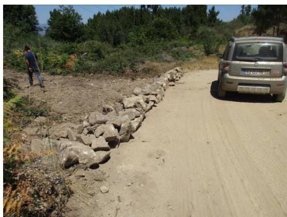
Fotografia 56 - Acesso ao apoio 30 descompactado.
