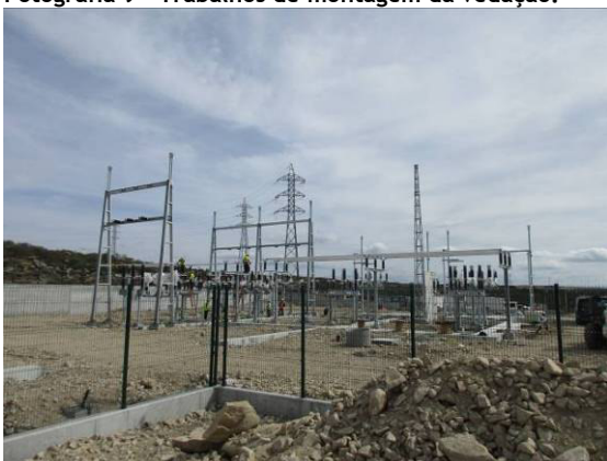
Fotografia 11 - Vista geral da Subestação.
