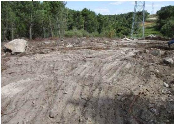
Fotografia 91 - Acesso ao apoio 49 descompactado.
