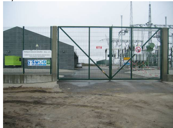
Fotografia 21 - Entrada do EC-SE com a devida sinalização de perigo e informativa.
