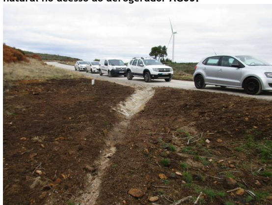
Fotografia 168 - Escapatória de valeta na via L7.
