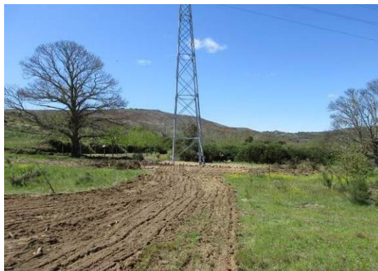
Fotografia 66 - Acesso à área de implantação do apoio 35 descompactado.
