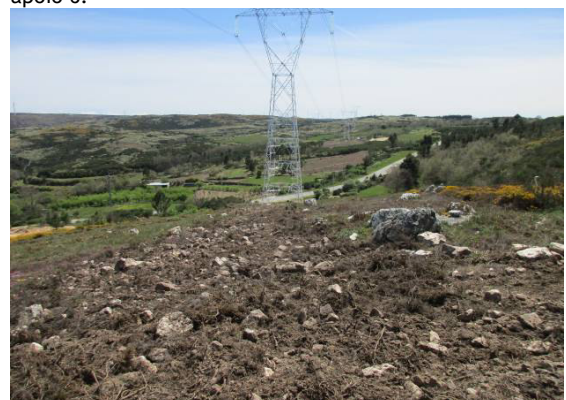
Fotografia 14 - Acesso ao apoio 6 descompactado.
