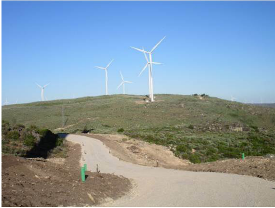
Fotografia 49 - Acesso do parque eólico (via F) sem qualquer material impermeabilizante.
