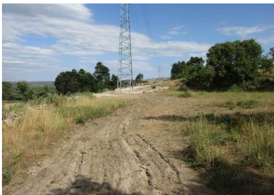
Fotografia 83 - Acesso ao apoio 45 descompactado.
