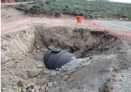
Fotografia 54 - Fossa estanque instalada na área de estaleiro para recolha das águas residuais provenientes das instalações sociais.
