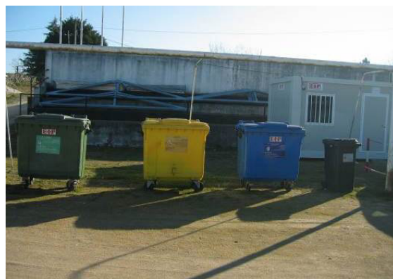
Fotografia 185 - Meios para deposição temporária de resíduos no estaleiro de Leomil.
