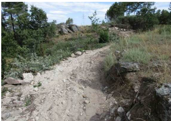
Fotografia 81 - Acesso ao apoio 44 descompactado.
