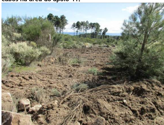
Fotografia 77 - Acesso ao apoio 42 descompactado.
