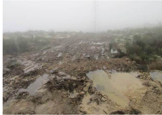
Fotografia 10 - Acesso ao apoio 2 descompactado.
