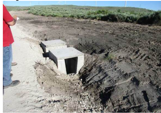
Fotografia 11 - Passagem hidráulica na via C.
