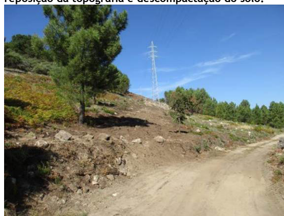
Fotografia 46 - Acesso ao apoio 23 descompactado.
