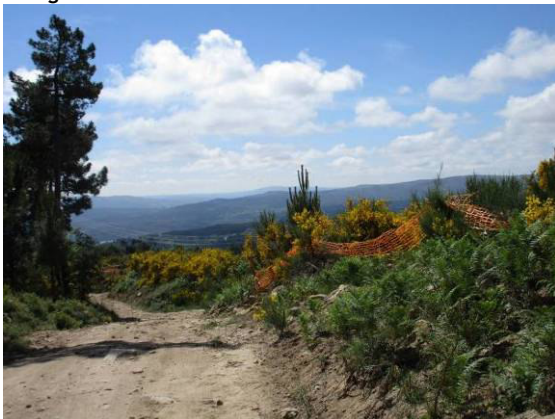
Fotografia 103 - Balizagem continua da via N1, entre os aerogeradores AG37 e AG38.
