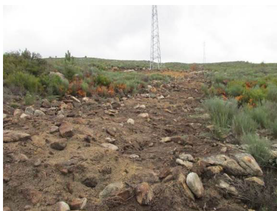
Fotografia 28 - Acesso ao apoio 12 descompactado.
