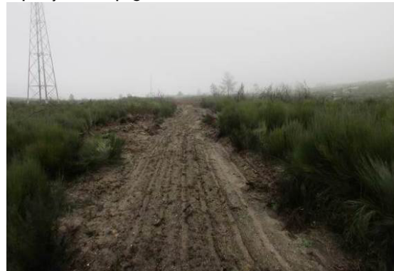
Fotografia 6 - Acesso ao apoio 1B descompactado.
