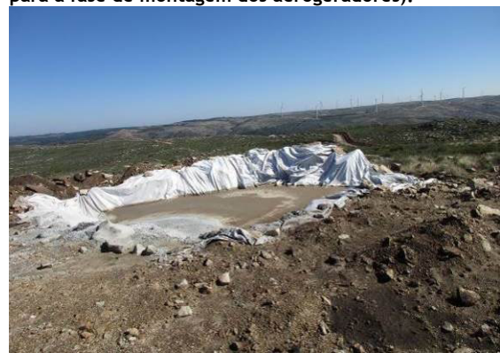
Fotografia 67 - Bacia para lavagem das caleiras das autobetoneiras na plataforma do aerogerador AG05.
