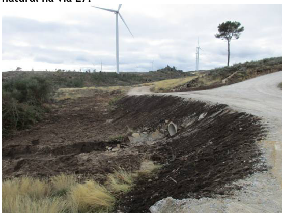
Fotografia 167 - Passagem hidráulica na via L7.
