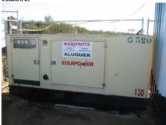
Fotografia 140 - Gerador instalado na área de estaleiro.
