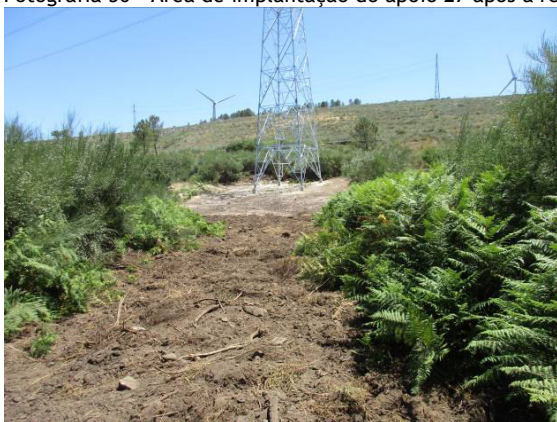
Fotografia 51 - Acesso ao apoio 28 descompactado.
