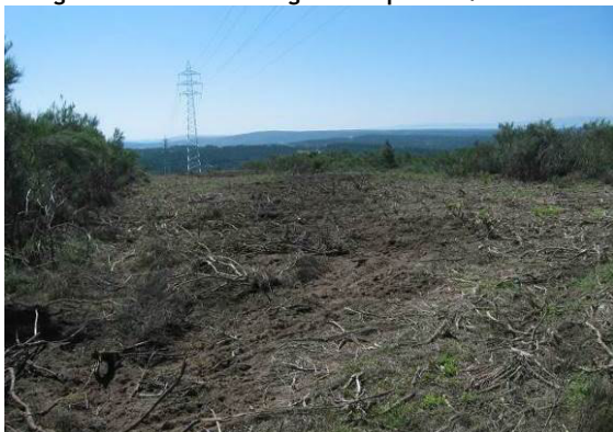
Fotografia 133 - Acesso ao apoio 70 descompactado.
