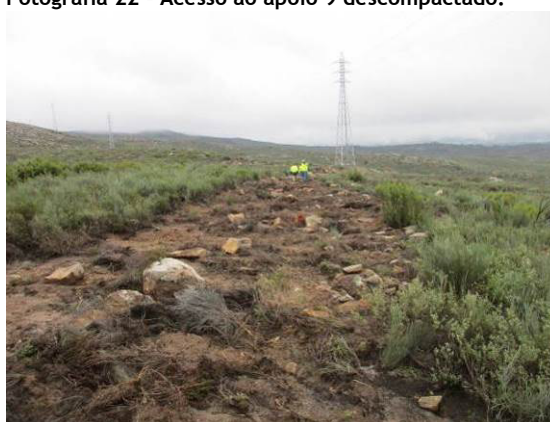
Fotografia 24 - Acesso ao apoio 10 descompactado.
