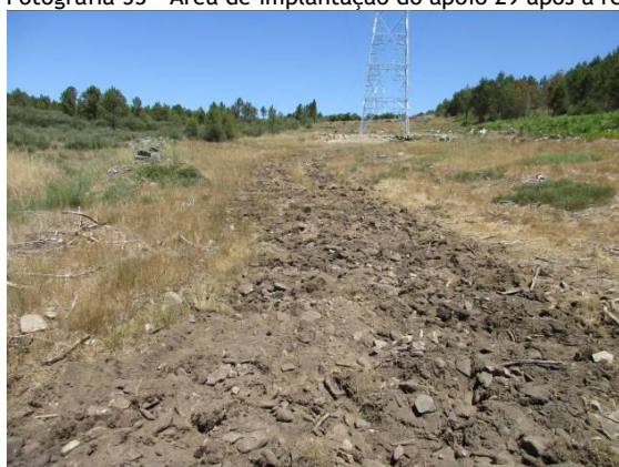
Fotografia 54 - Acesso ao apoio 29 descompactado.
