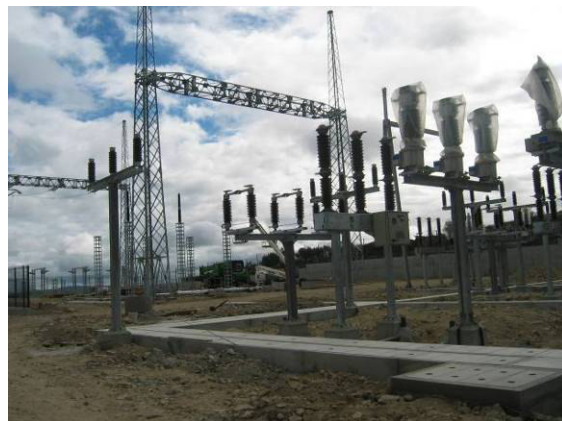
Fotografia 10 - Vista geral da Subestação.
