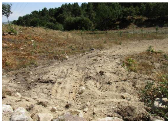
Fotografia 106 - Acesso ao apoio 56 descompactado.
