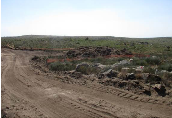
Fotografia 60 - Parga de terra vegetal localizada junto ao acesso entre os aerogeradores AG07 e AG08.
