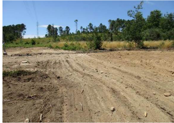
Fotografia 114 - Acesso ao apoio 60 descompactado.
