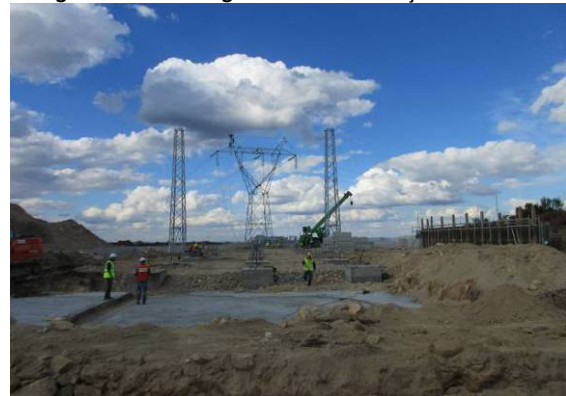
Fotografia 6 - Pórtico para ligação da linha de 400 kV na Subestação.
