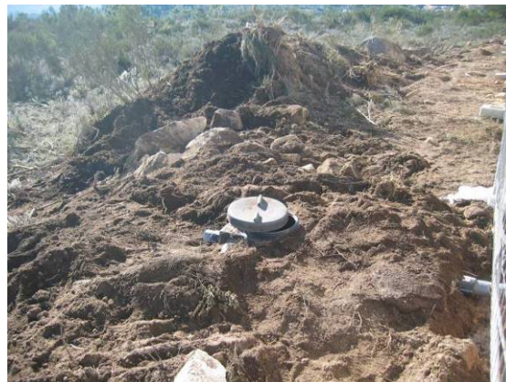
Fotografia 132 - Fossa estanque instalada na área de estaleiro para recolha dos efluentes domésticos produzidos.
